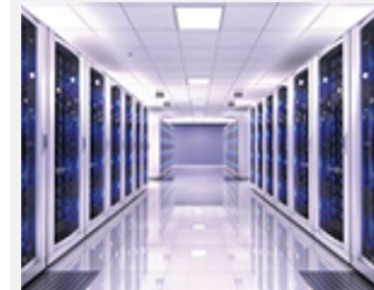
Grande Data Center
