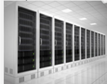
Pequeno Data Center
