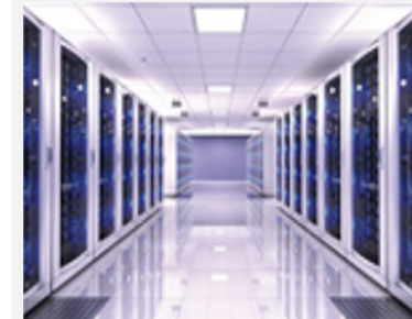
Grande Data Center
