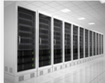
Pequeno Data Center
